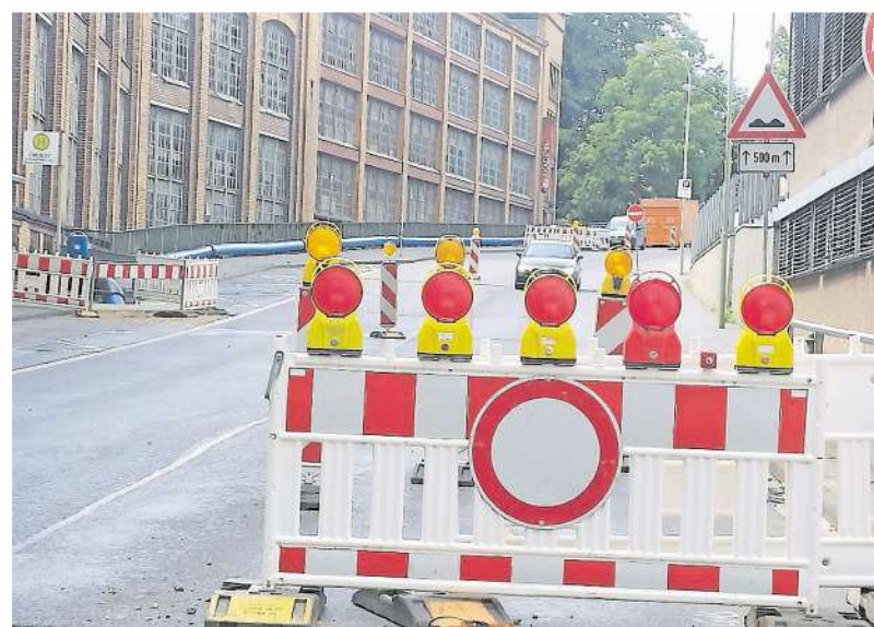
Noch ist die Finkensiefstraße einseitig befahrbar. Ab dem 1. August wird die Hauptverkehrsachse dann voll gesperrt.
